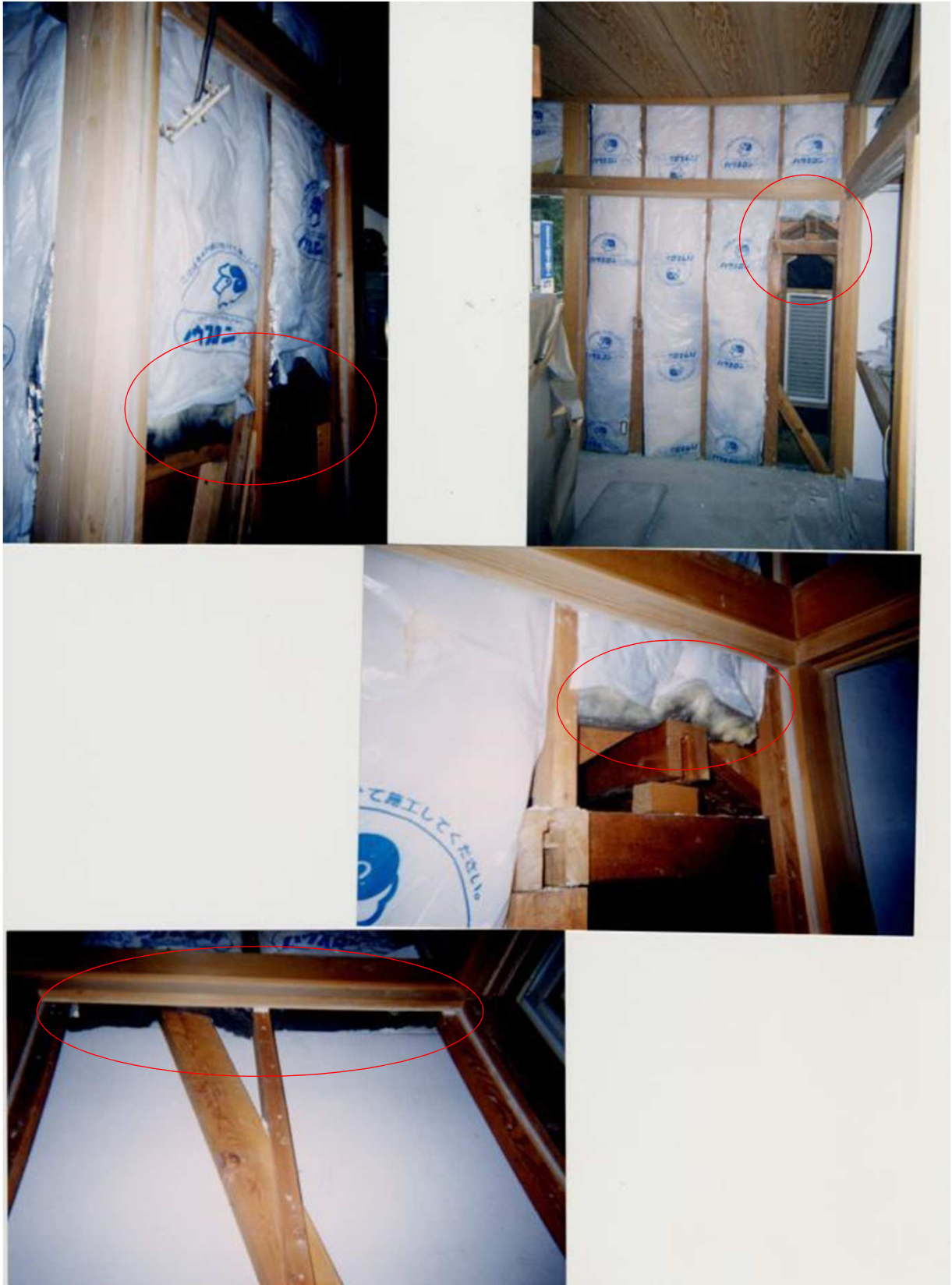
写真3-1-5 築7年目の住宅の壁断熱材（弊社解体現場より） ・外壁通気工法による乾式工法
