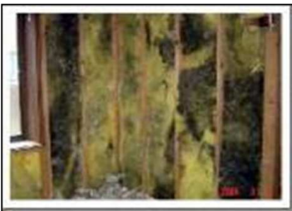
写真5-1-1 壁断熱材のカビ
