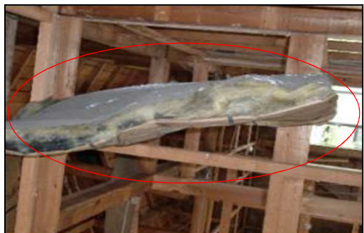
写真3-1-4 天井グラスウールカビ（弊社解体現場より）
