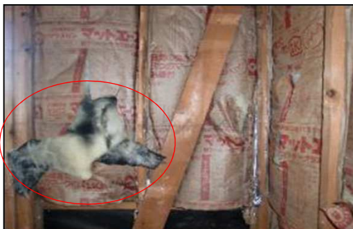
写真3-1-3 壁グラスウールカビ（弊社解体現場より）
