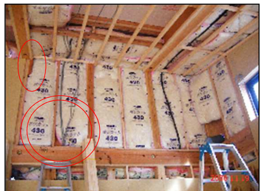
写真2-1-4 電気配線による断熱欠損部分
